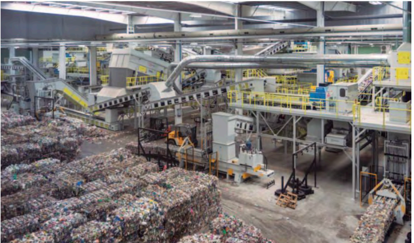
Interior de una Planta de incineración de residuos
