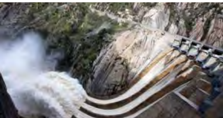
Central Hidroeléctrica de Aldeávila 2. Iberdrola
